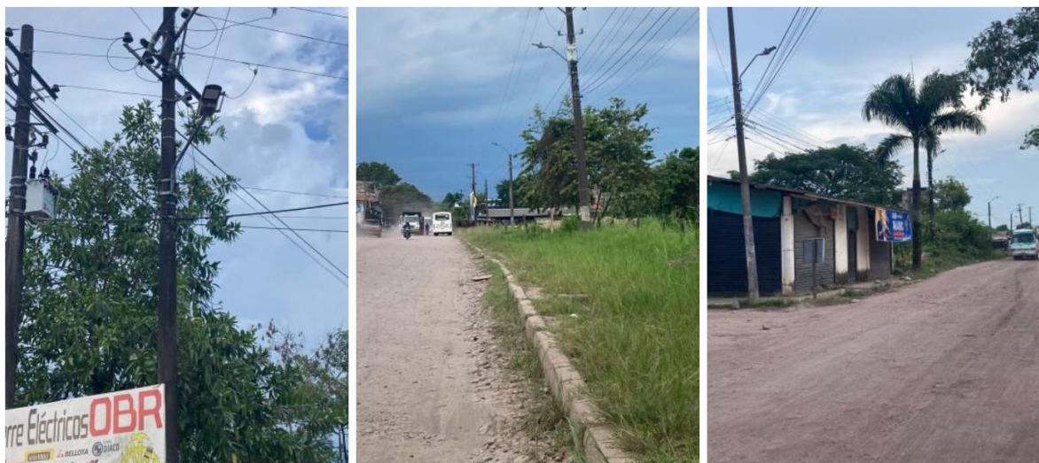
Ilustración 26. Evidencia fotográfica de disponibilidad del servicio de energía para la Carrera 18 este entre la avenida Colombia y calle 50.
