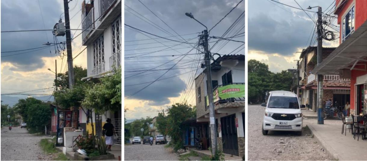
Ilustración 27. Evidencia fotográfica de disponibilidad del servicio de energía para la Calle 48 entre carrera 16 este y carrera 18 este del barrio los girasoles.
