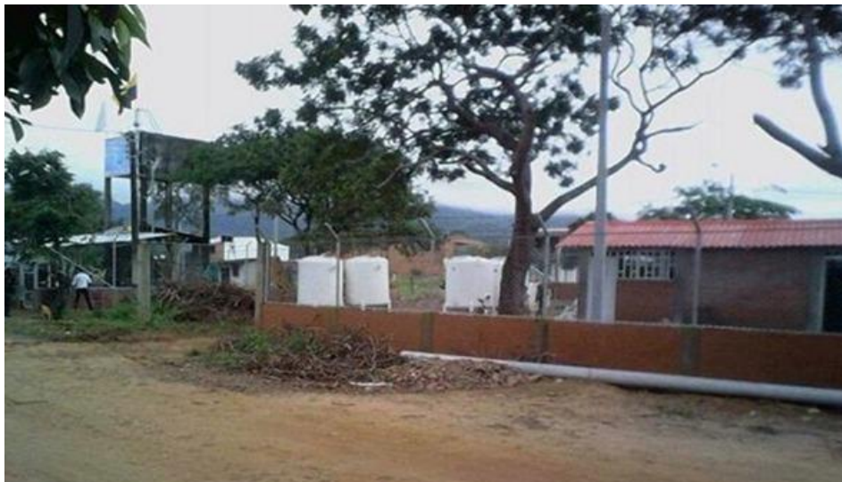
Ilustración 48. Pozo Profundo Y Planta de Tratamiento Llano Lindo. Fuente: Ficha de perfil básico suministrada por la Secretaría de planeación municipal de Yopal.
